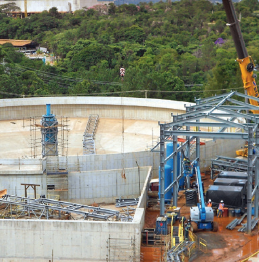
◀ Novos tanques de água recuperada
