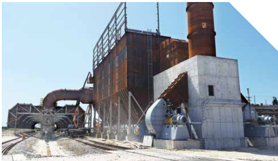
Obras civis do sistema de despeiramento da área de basculamento da gusa – CSP e terraplanagem (abaixo)
