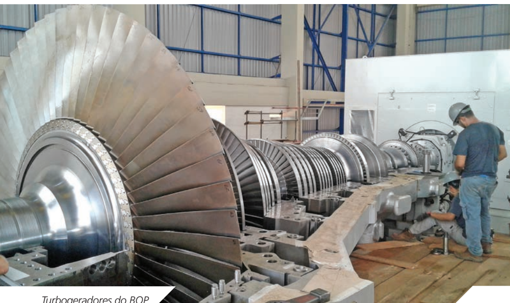
Turbogeneradores do BOP
