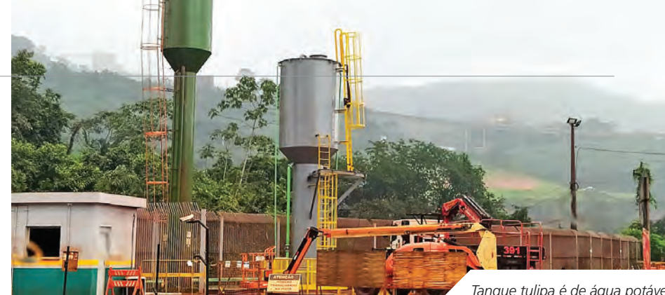
Tanque tulipa é de água potável
